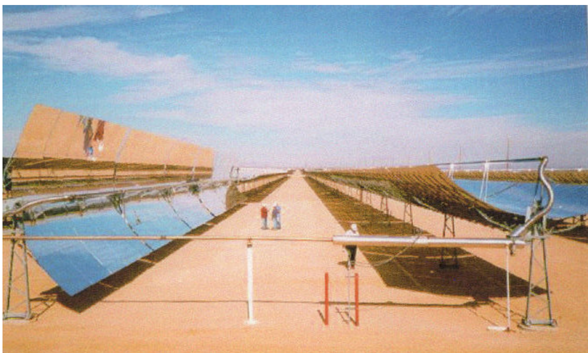
Figura 1. Instalación de colectores Cilindroparabólicos
